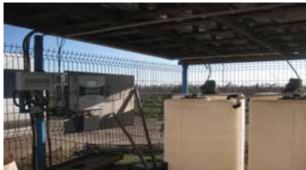
Figura 2.10. Centru de comandă fertigare
